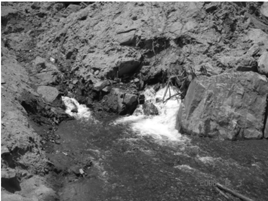
图 5 5 月 29 日发现的管涌渗水点(6 月 3 日拍摄)
