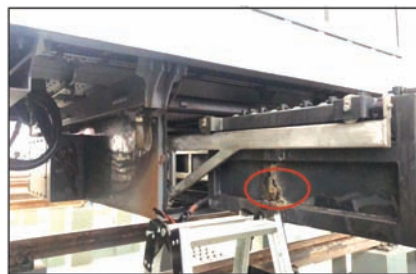
图8 蓄电池箱体烧损情况
