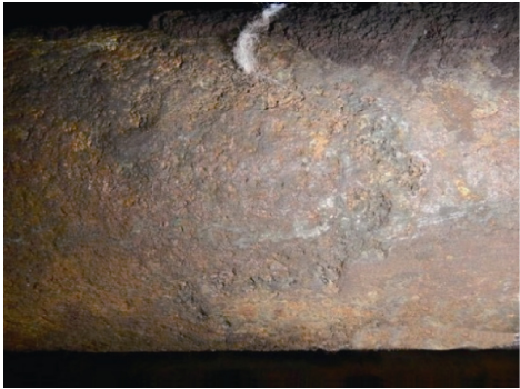
图 1 顶回流入入口分布管有大量腐蚀麻坑
