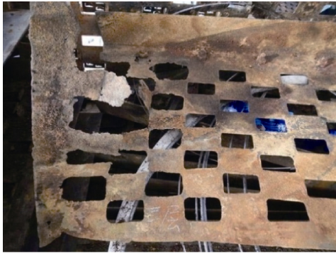
图 2 顶部塔盘腐蚀破损严重
