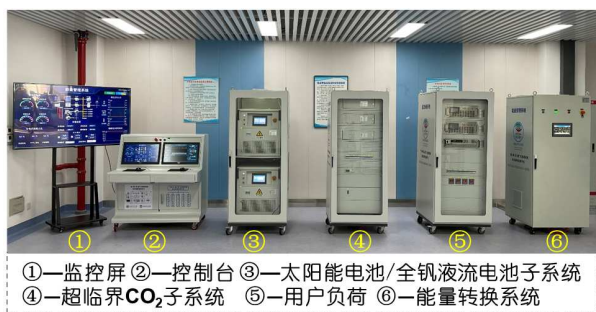
图2 “源-网-荷-储”综合能源系统动态调控实验平台
