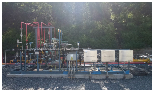
图2 天然气管道随动流量掺氢实验系统实物图
