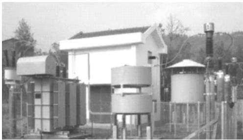
图5 网压提升装置现场图
