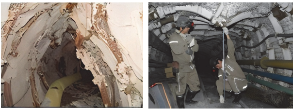
图 1 原锚网索喷 U 支护巷道围岩破坏情况 [27]
