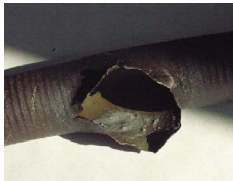
图4 氯化铵腐蚀造成管线破裂
