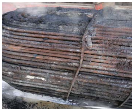
图2 换热器管束穿孔
