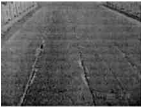
图3 板梁铰缝破坏
