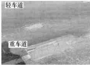
图4 轻重车道铺装层损坏差异
