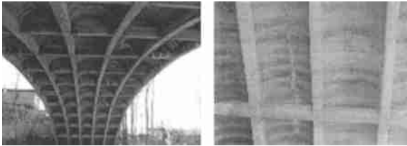
图2 某双曲拱桥拱波纵向开裂
