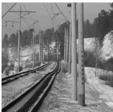
图 1 Transbaikalian 铁路路基沉陷 [2]
