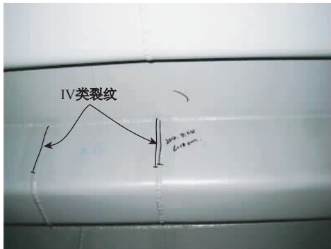
图 9 实体桥嵌补段裂缝
