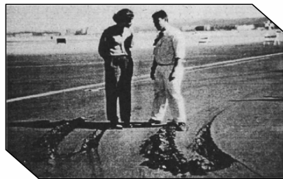
图 2 沥青道面弯道处剪切破坏
