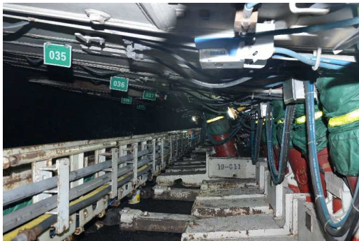
液压支架运行状况
