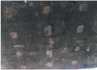
图 7 混凝土预制底板的最终破坏情况
