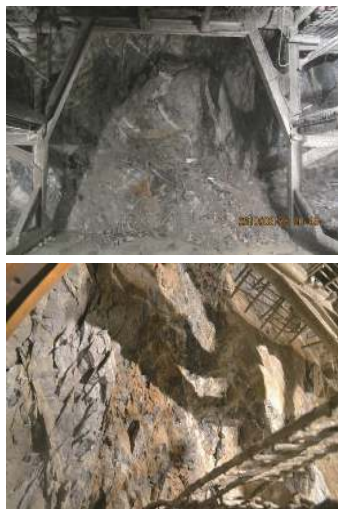
图 4 滑坡下方 102 隧道掌子面照片 [11]
