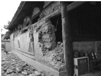
图 1 汶川地震某古建筑震害照片
