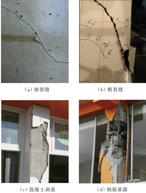
图 5 从外部获取的 RC 构件损伤图片
