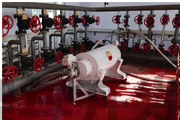
图 15 MRMF 在油田计量间内应用现场图
