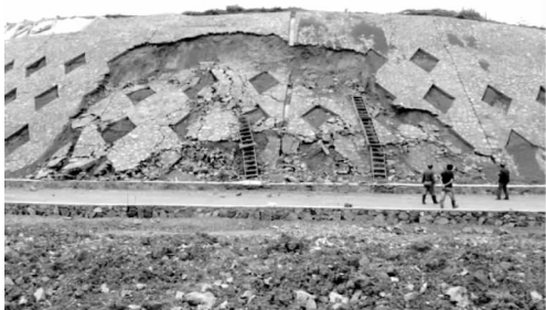
图11 余凯FK+090边坡坍塌
