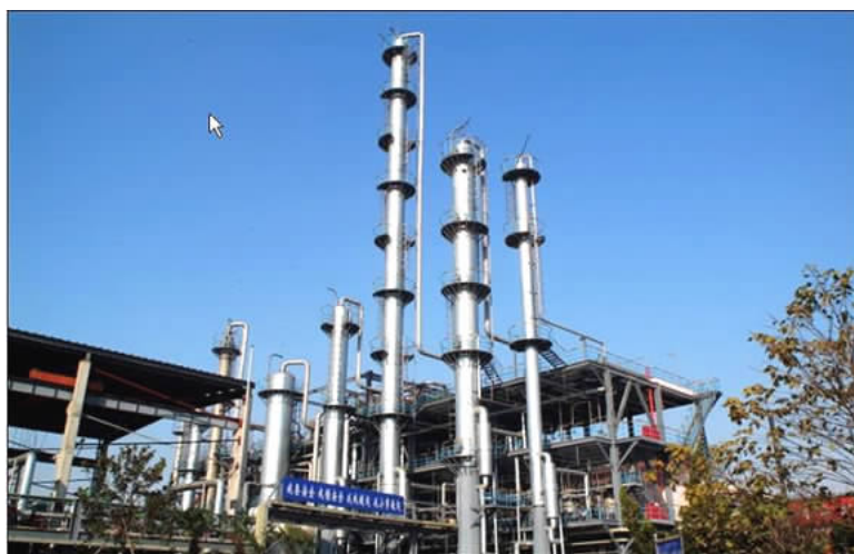
图3 20 万吨/年乙二醇工业示范装置
