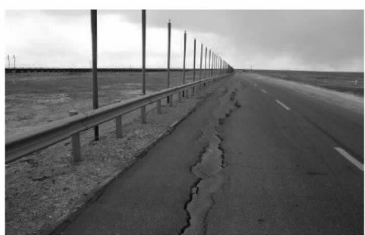
图 3 青藏公路清水河段热管路路基纵向裂缝
