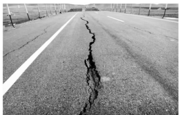
图 2 中科院试验路热棒路基纵向裂缝
