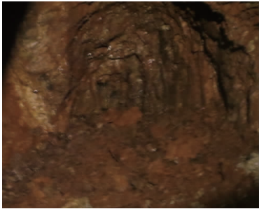
(a) 侧墙拉裂-滑移形成的空洞
