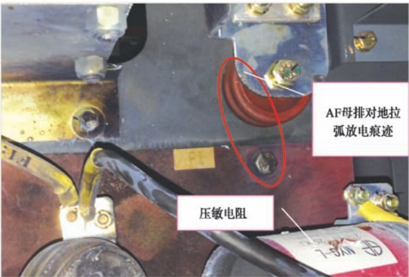
图 3 压敏电阻烧损
