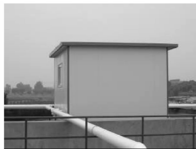
图2 复合式生物除臭反应器现场照片
