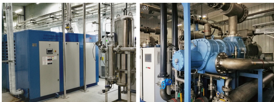
图6 新型线氦气螺杆压缩机应用于首台全国产液氦制冷机(a)及510 W超流氦(−271°C)大型低温系统(b)
