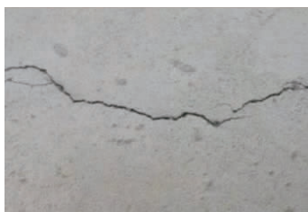
(a) 裂缝原图像
