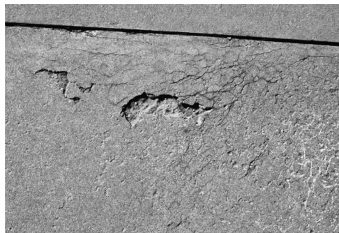
图1 混凝土表层剥蚀
