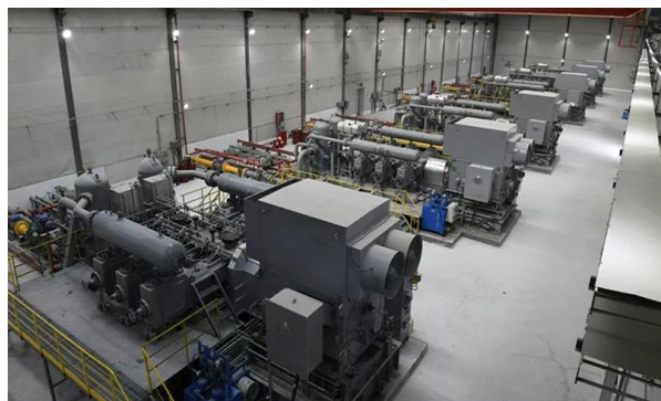
图 1 文 23 储气库注采站压缩机厂房
