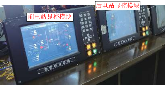
图 11 舰船并网控制装置中的监控系统联调实物图
